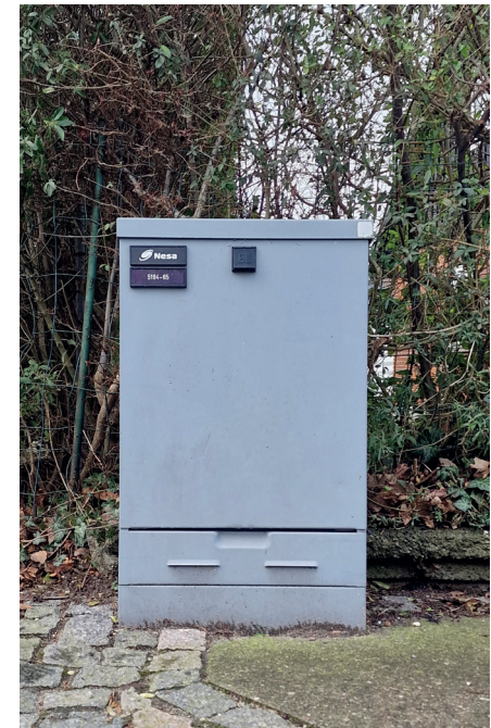
Kabelskab på Ørumvej. Foto: Oktober 2022
